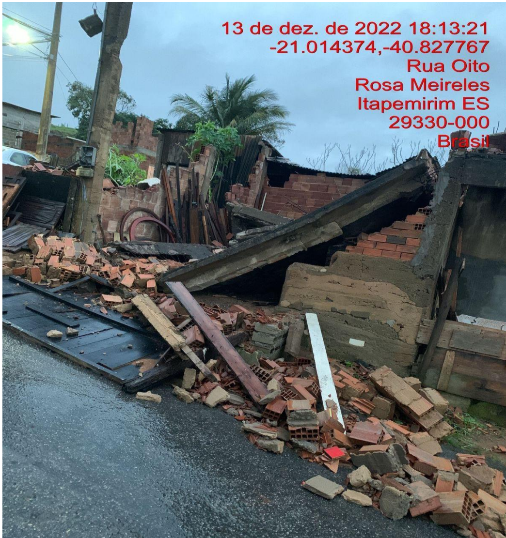
Foto 16: desmoronamento da laje de cobertura numa residência (não houve feridos). Fonte: Arquivo Defesa Civil
