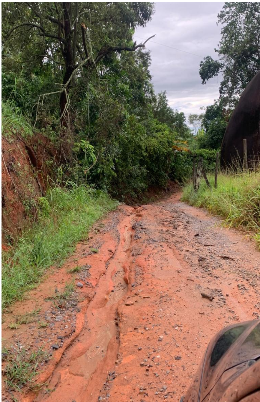
Foto 21: deslizamento de encosta, obstruindo a estrada vicinal (2023). Fonte: Arquivo Defesa Civil
