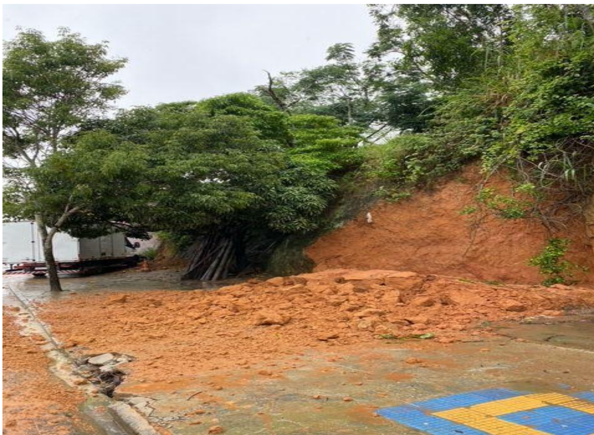
Foto 18: deslizamento no talude de corte em 2019. Fonte: Arquivo Defesa Civil
