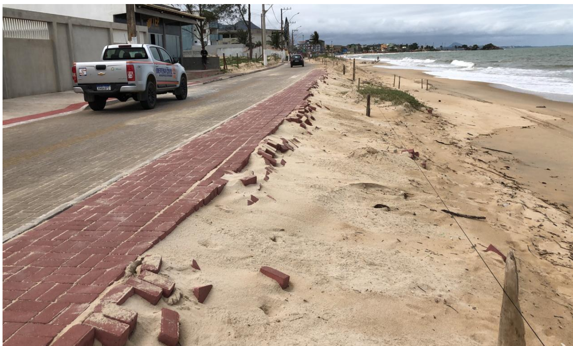
Foto 22: Calçada da praia de Itaoca danificada em 2018. Fonte: Arquivo Defesa Civil
