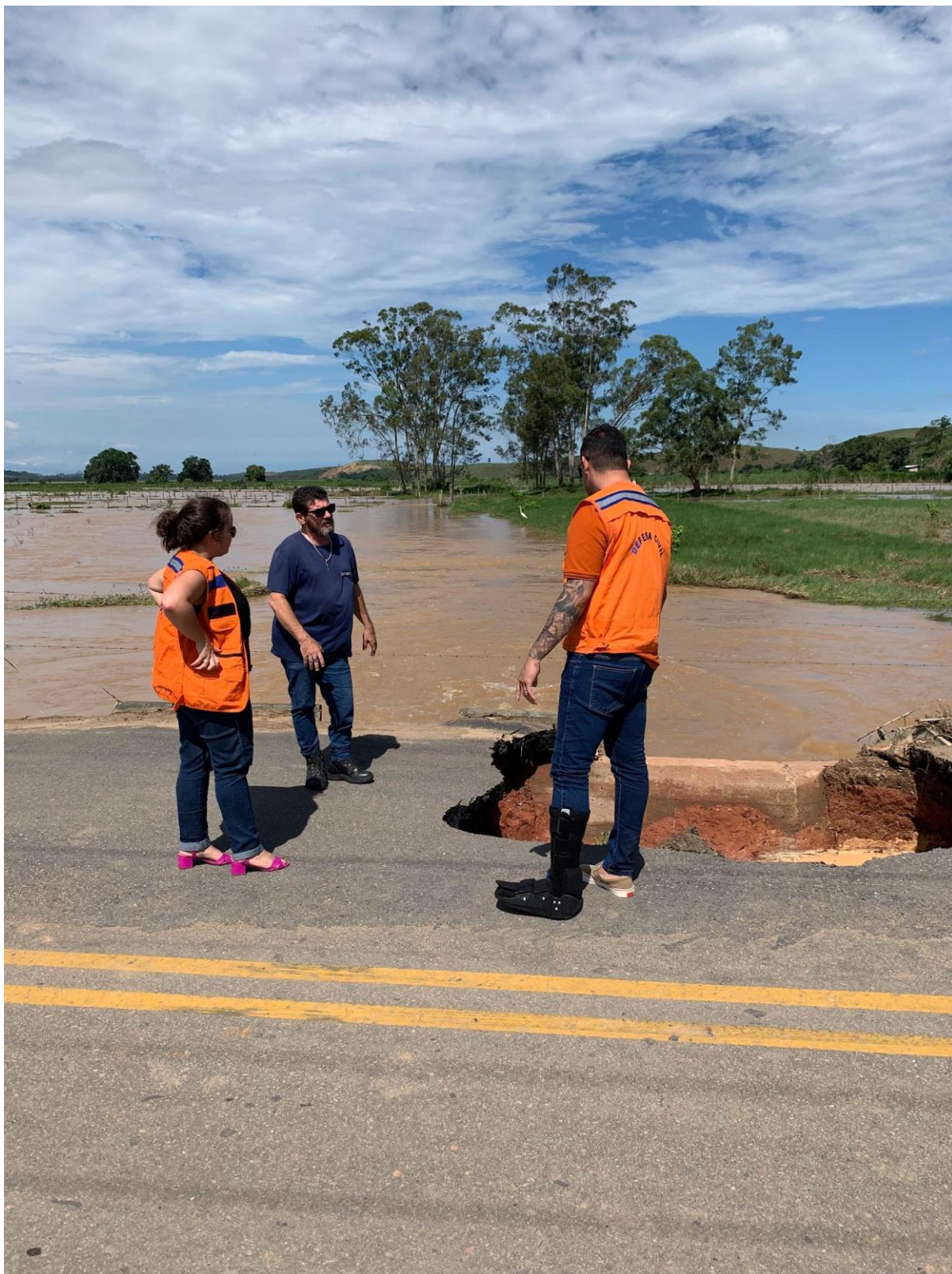
Foto 27: Processo erosivo em estrada, tendo por impacto a remoção de parte da via de acesso em 2023. Fonte: Arquivo Defesa Civil
