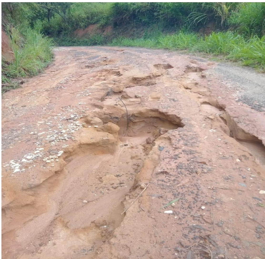
Foto 24: Erosão em estrada vicinal em 2022. Fonte: Arquivo Defesa Civil
