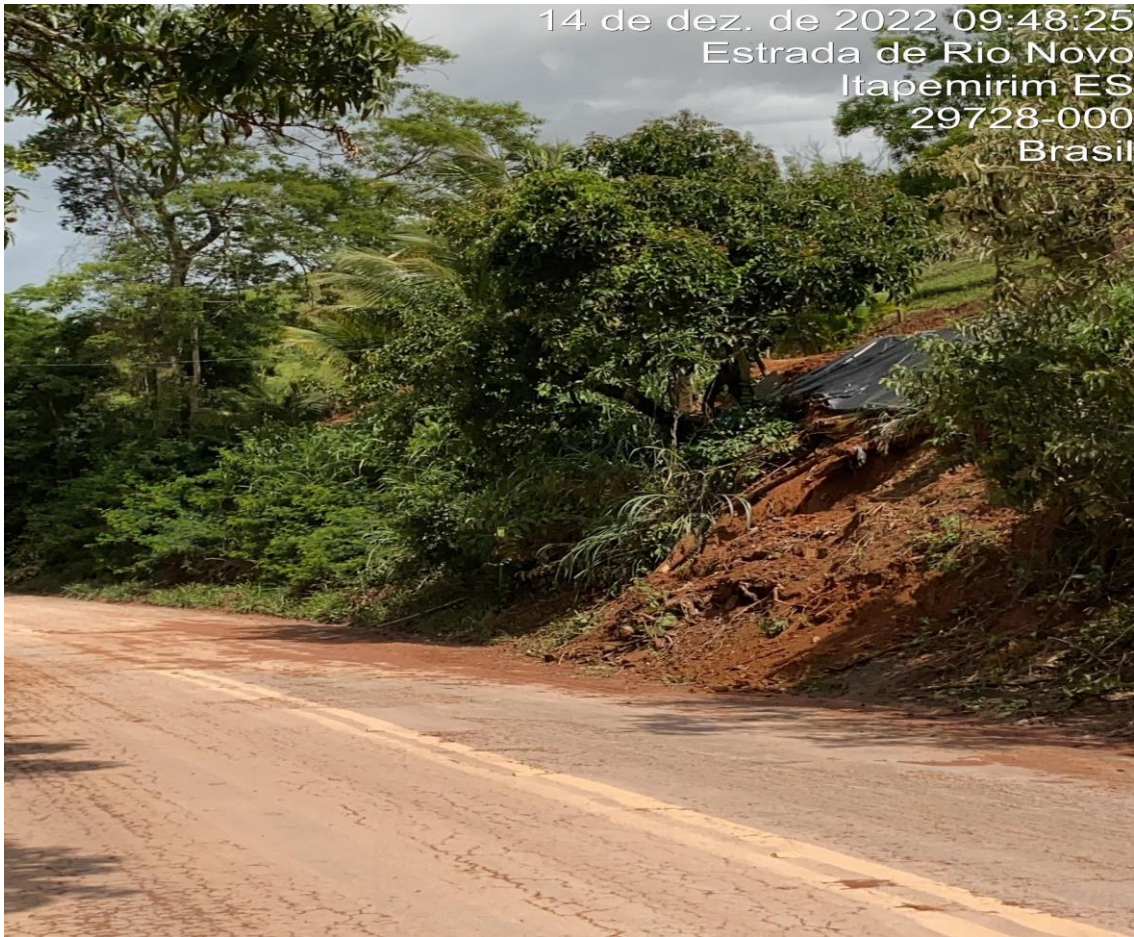
Foto 20: deslizamento de talude próximo à Rodovia. Fonte: Arquivo Defesa Civil
