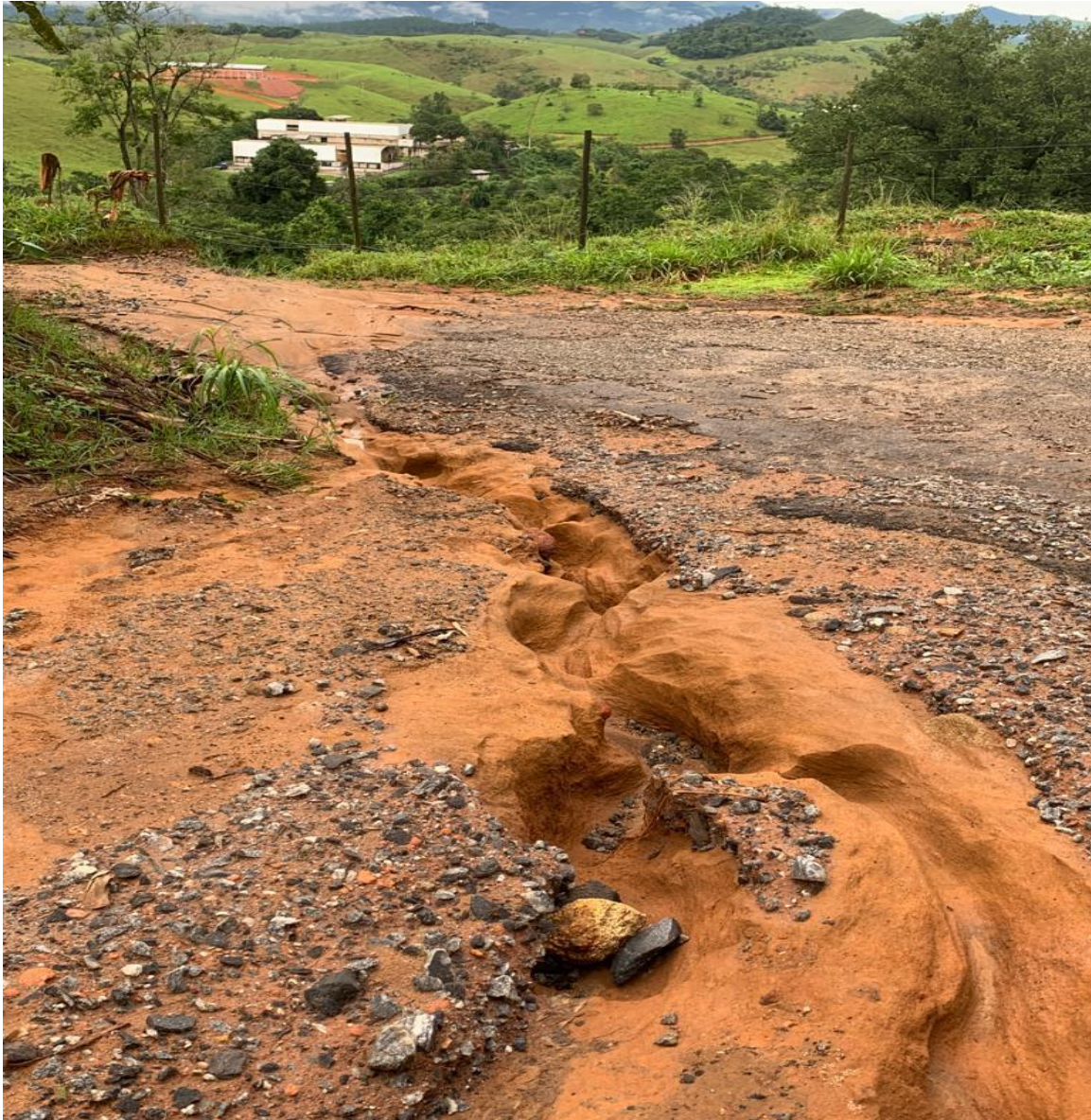
Foto 25: erosão em estrada de acesso a comunidade em 2022. Fonte: Arquivo Defesa Civil
