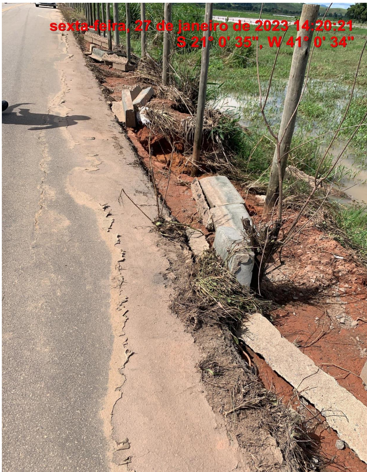
Foto 26: lancil da estrada danificado, agravando o processo erosivo. Fonte: Arquivo Defesa Civil
