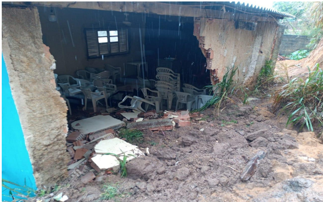
Foto 19: deslizamento destrói parede de um Igreja (não havia fiéis no local) -2017. Fonte: Arquivo Defesa Civil
